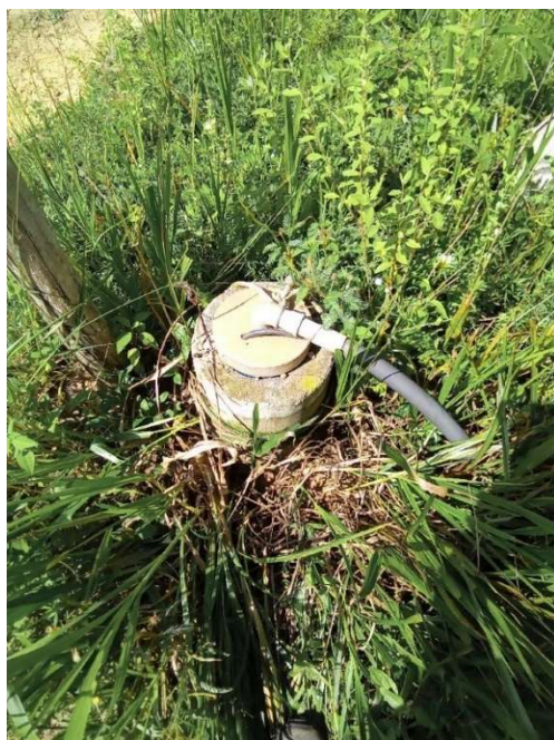
(a) Poço para abastecimento
